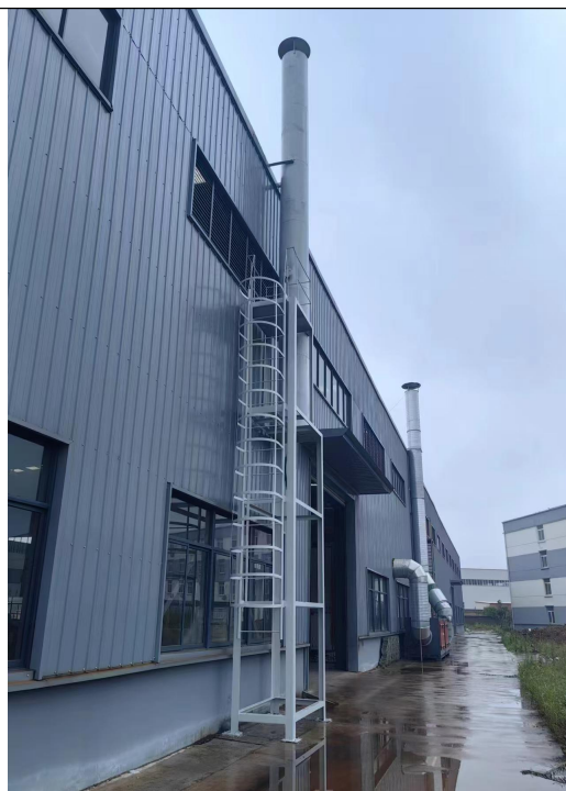
废气处理设施
