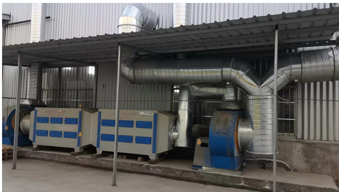
二级活性炭吸附装置+15m 高排气筒
