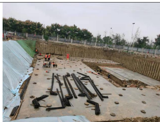
厂区西北-消防水池
