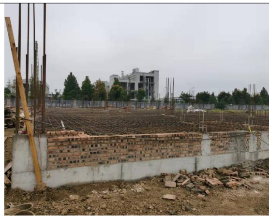
厂区西南-控制室
